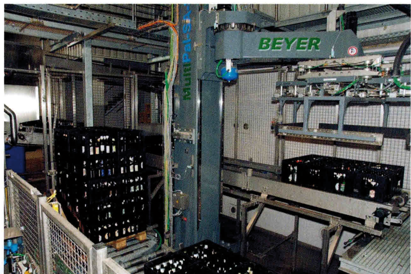
Für die Be- und Entpalettierung installierte man zwei Hochleistungsmaschinen MultiPal SA 3A; 100 Paletten/h können entladen, bis zu 75 Paletten/h beladen werden
